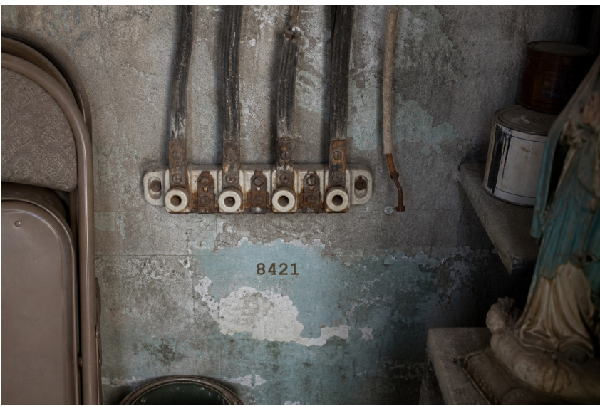
Abb. 6 · Anschlussleiste in der Caseta. Der fünfte Leitungsweg ist für den kontrollierten Trennversuch gelöst; unter der Farbe wurde 8421 freigelegt.
