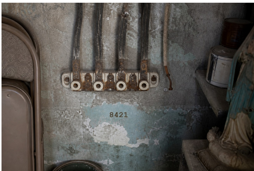
Fig. 6 • Regleta de conexión en la Caseta. La quinta ruta de la línea está disuelta para la prueba de separación controlada; bajo la pintura se ha descubierto 8421.
