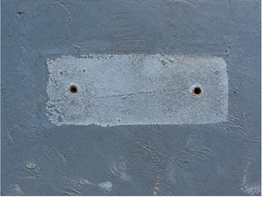
Detail der fehlenden Plakette: hellere Lackfläche, zwei Schraubenlöcher und Abrieb. Aus dem Oberflächenbefund folgt keine sichere frühere Nummer.
