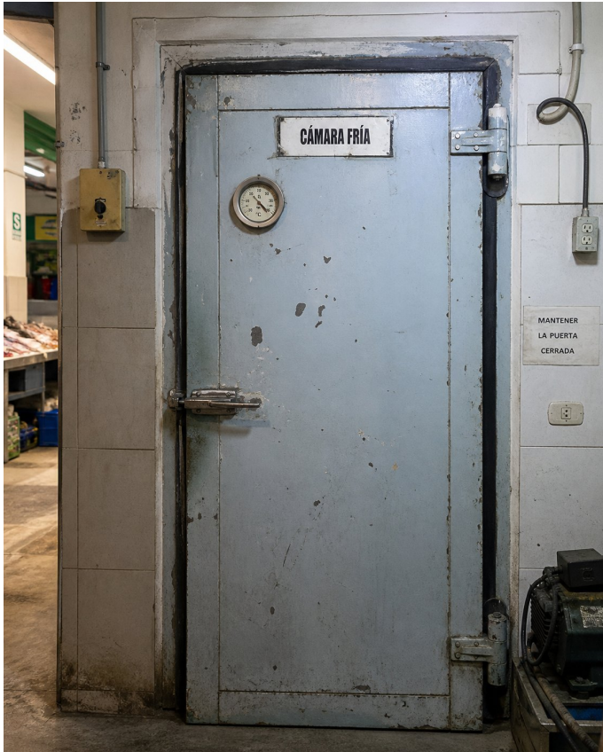
Ältere Kühlraumtür mit Thermometer und mehreren Reparaturspuren. Keine einzelne Lackschicht entspricht dem gesamten Nutzungszeitraum.
