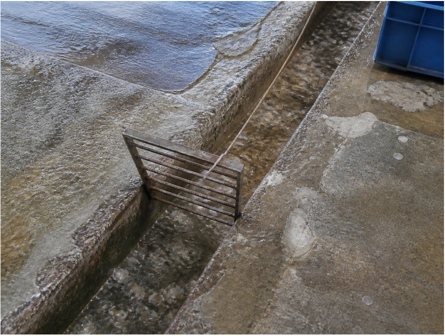
Ablaufrinne mit durch Draht offengehaltener Abdeckung. Einfache Arbeitslösung, fotografisch dokumentiert 2026.
