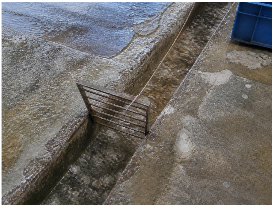
Figura 20. Canaleta de desagüe con la tapa sostenida abierta mediante un alambre. Solución práctica sencilla, documentada fotográficamente en 2026.
