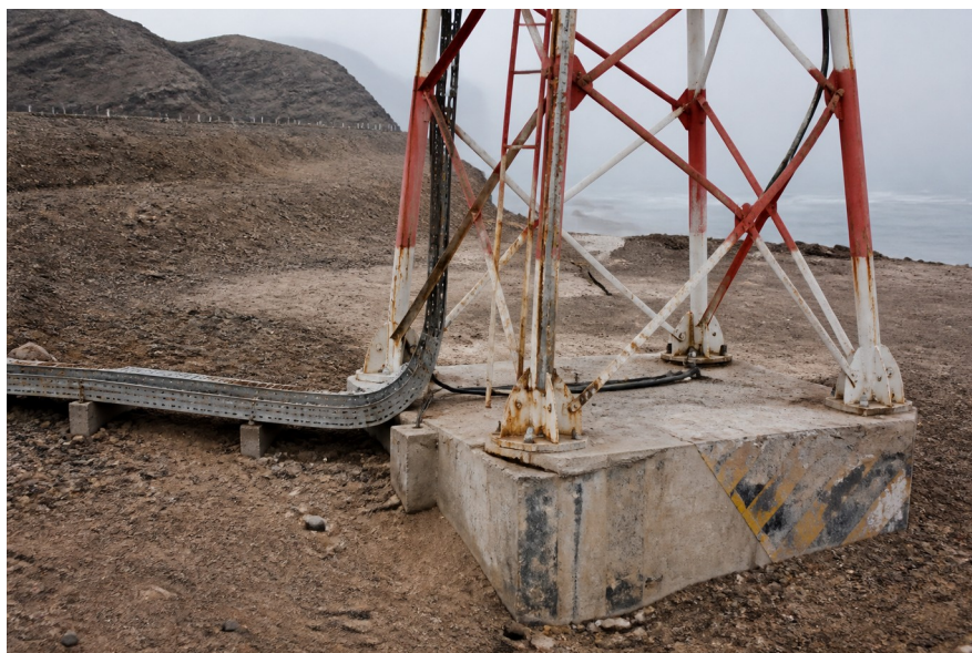
Mastfundament und Kabelzuführung. Aufnahme: Ana Belén Vargas, 2026.
