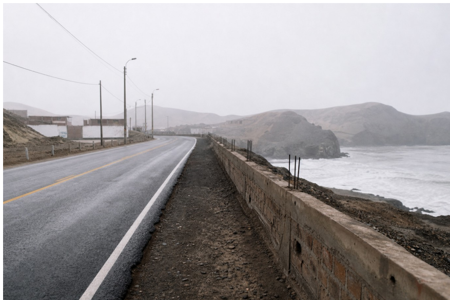
Kurve nördlich von El Faro. In mehreren Meldungen wurde sie über die unfertige Mauer beschrieben.
