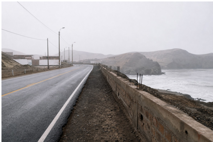
Curva al norte de El Faro. Fue descrita en varios informes relacionados con el muro sin terminar.
