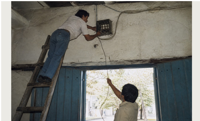
Mantenimiento del sistema eléctrico antes de un evento. Reconstrucción fotográfica conforme al plan de imágenes.
